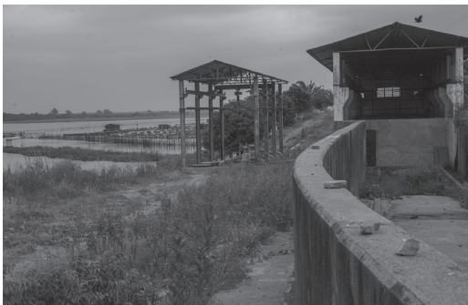
Fig 2.9 Asutsuare Irrigation Pumps
